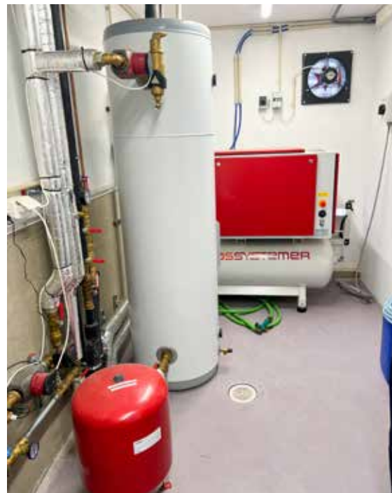
Teknisk rom med varmtvannstank som varmes med vannbåren varme – og spillvarme fra melkekjølingen.
