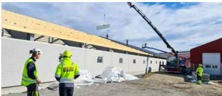
Her legges taket på fjøset parallelt med at det støpes gulv innvendig. Foto: Margrete Nøkleby.
