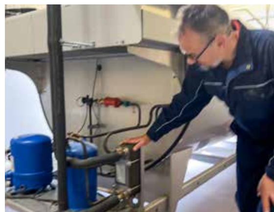
Varmeveksleren på melketanken er koblet til anlegget med vannbåren varme. Forkjøling av melka er aktuelt å ettermontere.
